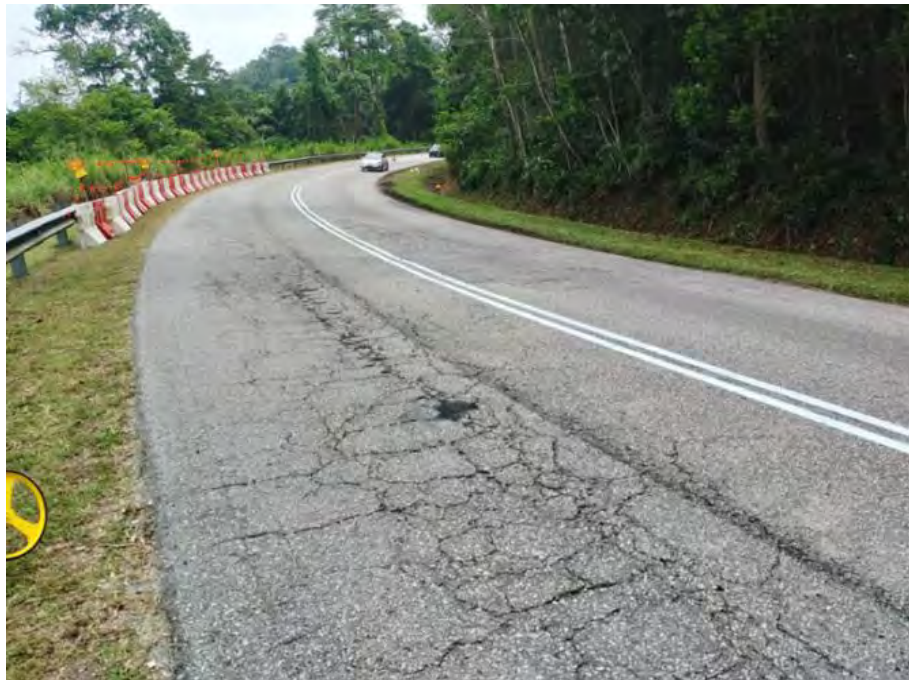
Gambar Rajah 10. Kerosakan Permukaan Jalan
